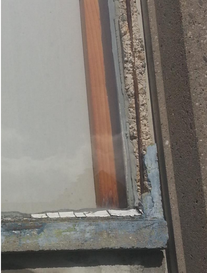
De aantasting van een betonnen raamkozijn door corrosie met blootliggend betonijzer
