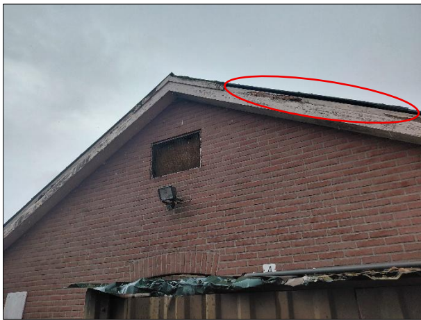
Ontbrekende plank aan windveer
