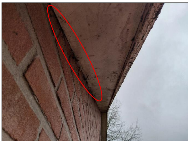
Een kier die vleermuizen toegang kan bieden tot holle ruimtes achter de gevelbetimmering en in de spouwmuur
